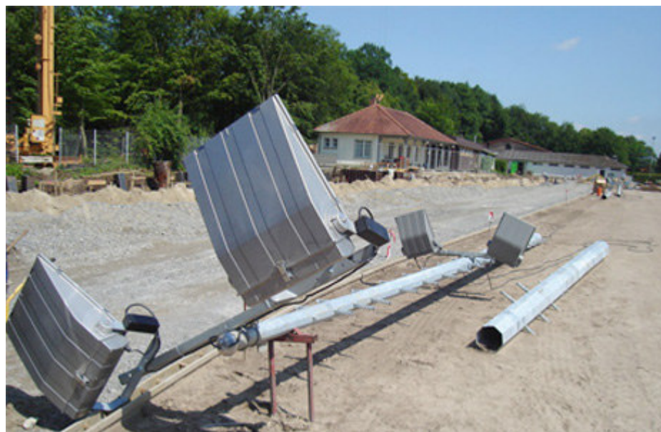
Einer von insgesamt sechs Flutlichtmasten vor der Aufstellung in Versmold. Bild: Ingenieurbüro Rößler
