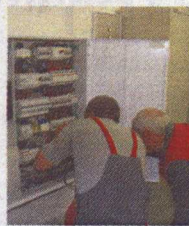
In einer Ecke des Vereinsheim. Kontrolle des Steuerungskastens.
