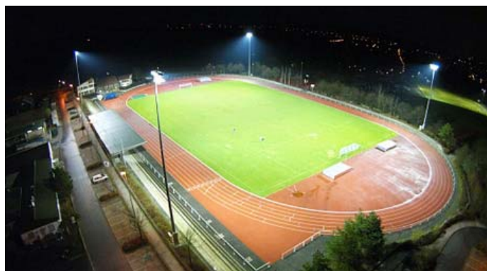
Die Beleuchtungsprobe unmittelbar nach der Feinjustage der Scheinwerfer Alle Bilder: IBR Flutlicht GmbH
