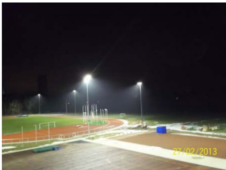
Die Beleuchtungsanlage besitzt eine Leistungsaufnahme von 65 Kilowatt
